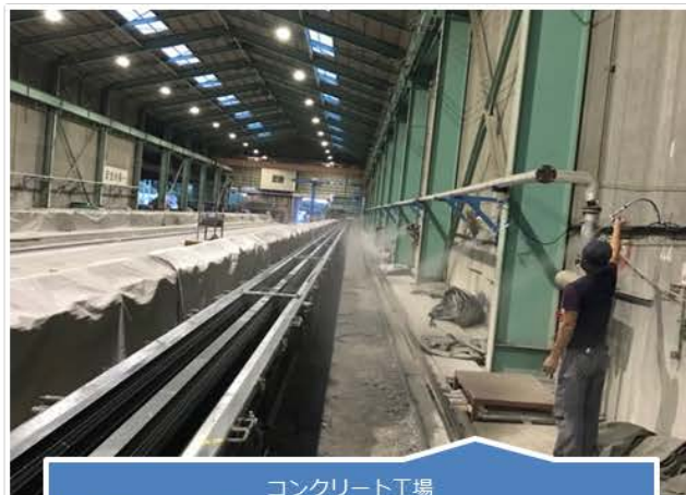
コンクリート工場
